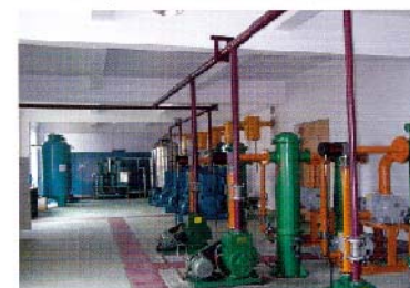
变压器油处理系统 Oil process system
